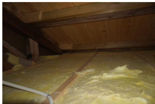
Ingen lufting av konstruksjonen
