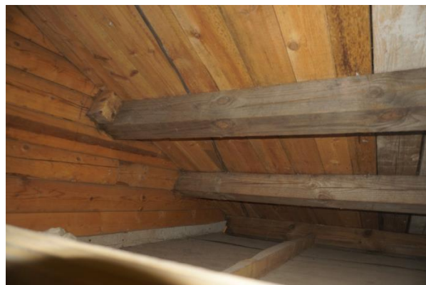
Ingen isolasjon eller lufting.
