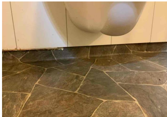
Ikke synlig drenering fra innebygde sisterner
