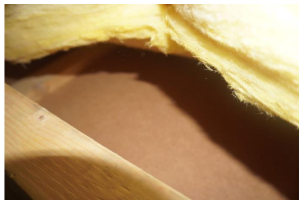
Ingen dampspærre mot kaldloftet
