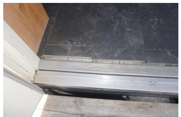
Laminat som ikke går helt inntil ytterdør.
