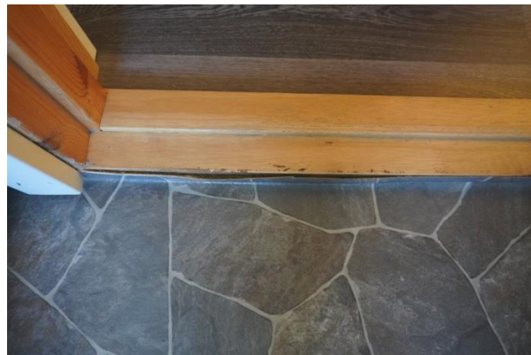
Gulvbelegg ikke tett ved dør.
