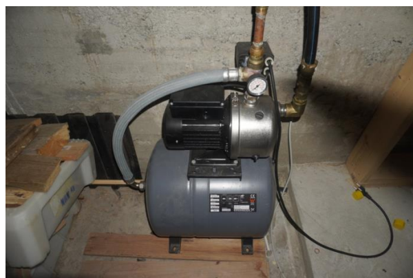
Vannpumpe i kjeller
