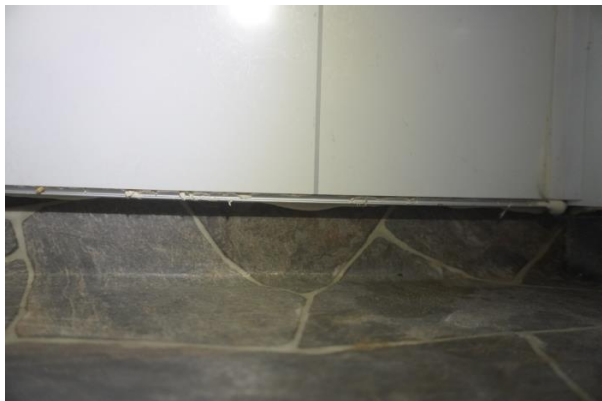
Ikke silikonert mellom sokkellist og veggplate
