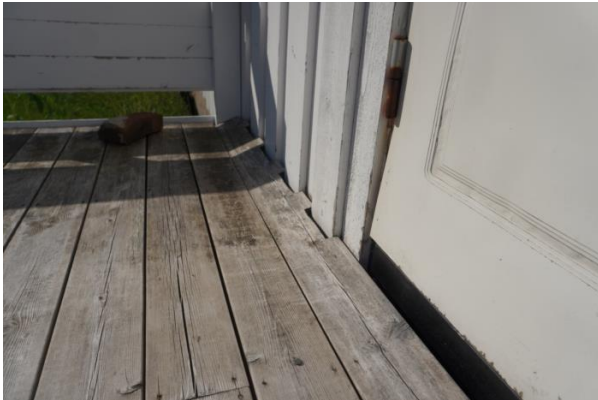
Svikt i innfestingen/fundamenter under
