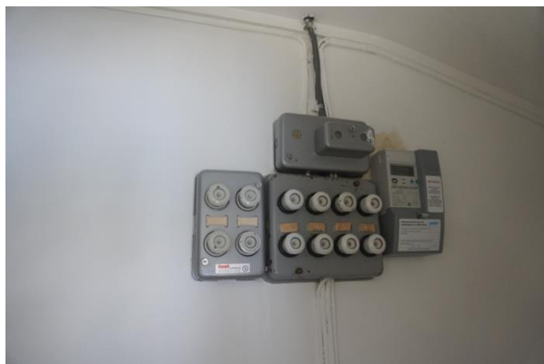
Sikringsboks med skrusikringer på vegg.
