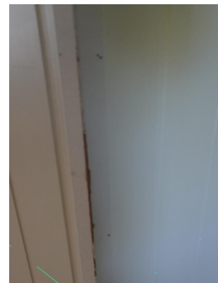
Skader i veggplate på utvendig hjørne.
