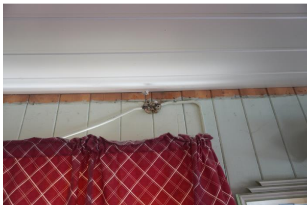
Åpen koblingsboks, ikke deksel over.
