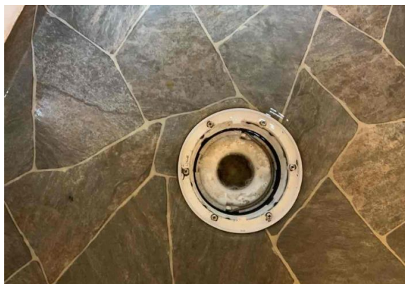
Gulvbelegg klemte i sluk
