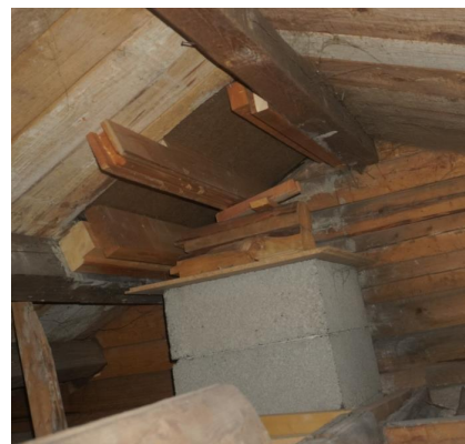
Pipe avsluttet på kaldloftet
