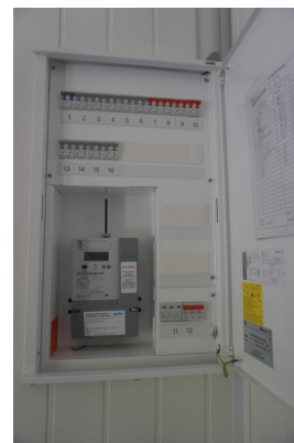
Sikringsskap med automatsikringer
