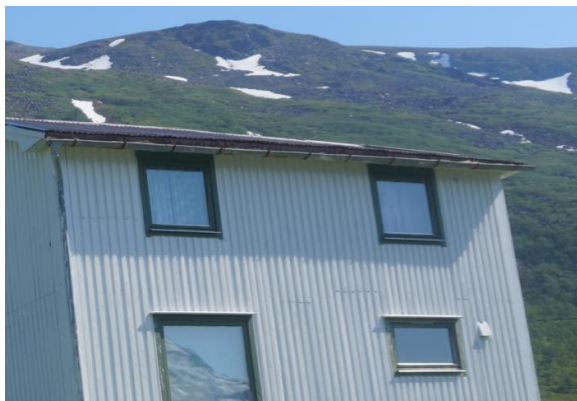
Takrenner og nedløp i metall
