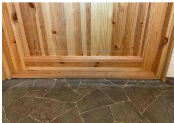
Ikke tilluft ved dør
