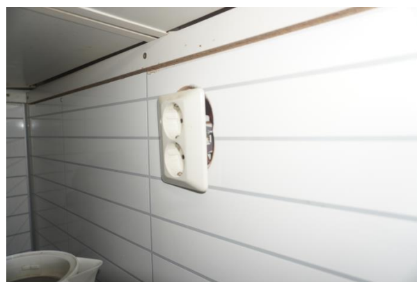
Løs stikkontakt på kjøkken
