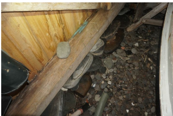
Line på nautstein, noe råteangrepet
