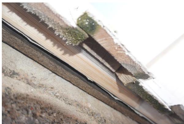
Vindsperre ikke klemt mot mur.
