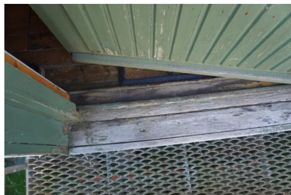
Dørkarm og terskel er råteskadet
