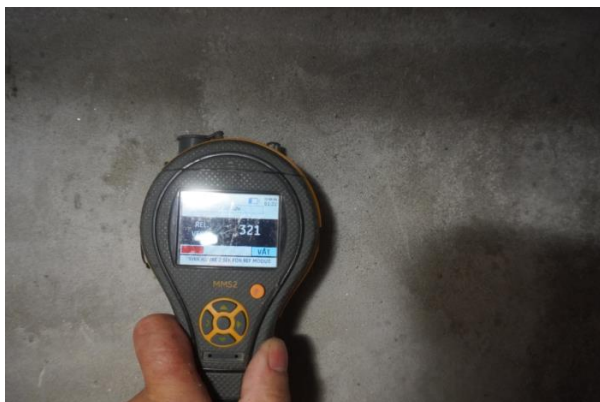
Forhøyet fuktverdier i betongvegger
