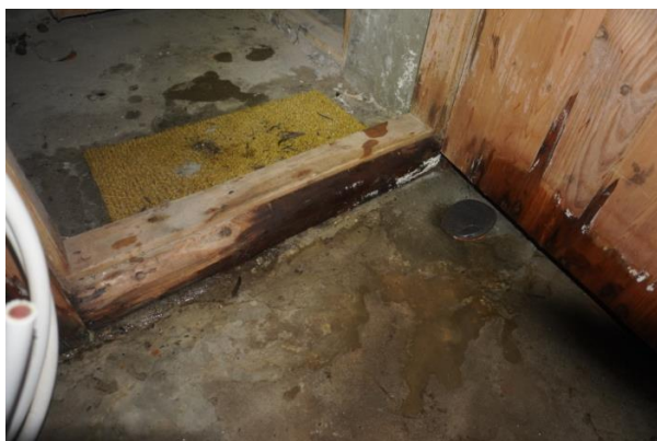
Råteskadet dør og vegger i kjeller
